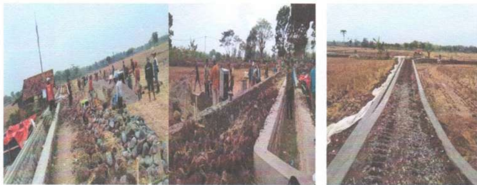
Dokumentasi pelaksanaan Program Padat Karya Tunai Pembuatan Tembok Penahan Tanah di salah satu lokasi yaitu Desa Cibentar Kec. Jatiwangi
